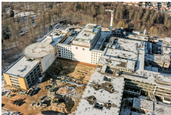
Zwischen Haus C mit Hubschrauberlandeplatz auf dem Dach (links) sowie dem bestehenden Haus K (oben) sowie den alten Bestandsgebäuden (rechts) soll auf der geschaffenen Freifläche im Bauabschnitt IIIa der Neubau Haus L entstehen. Bildnachweis: Klinikum Heidenheim
